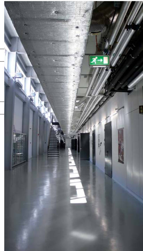
Haustechnische Installationen Korridor EG/Trakt B
