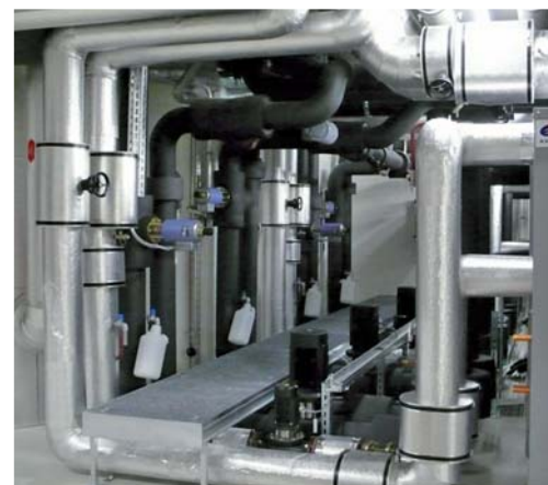
Verrohrung der Wärmepumpen (isoliert)
