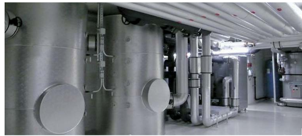
Heizungsspeicher in der Zentrale
